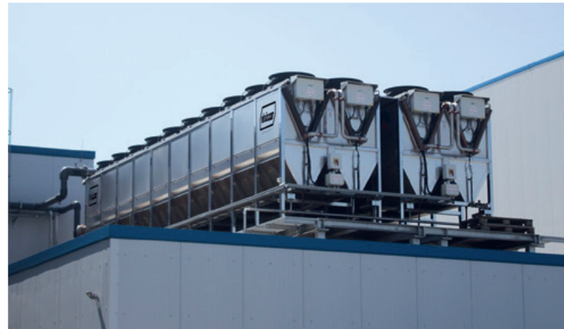
Seit über einem Jahr ist der 3DK-Kühler bei NKT in Betrieb. © Elsässer Kältetechnik
